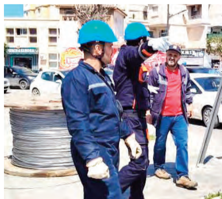
ربط 5600 مسكن بشبكتي الكهرباء والغاز
